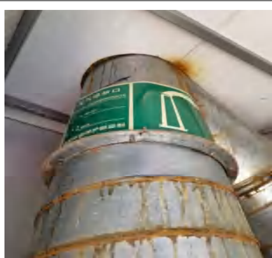
精制工段袋式除尘器及 DA007 排气筒
