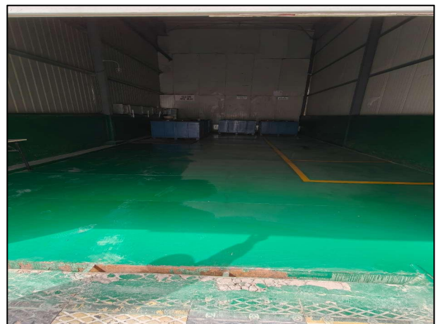
现有工程危废间内部
