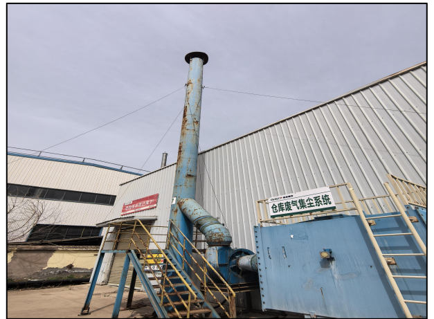
现有工程危废间废气治理措施和排气筒
