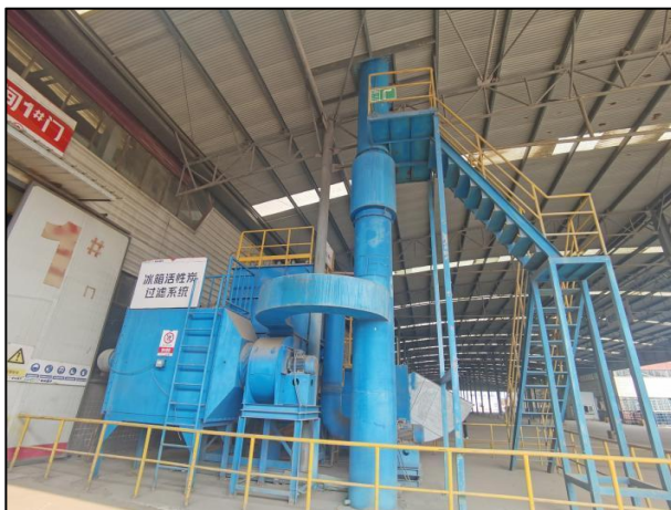
项目冰箱冷媒回收和 CRT 粗拆废气排气筒 (DA004)
