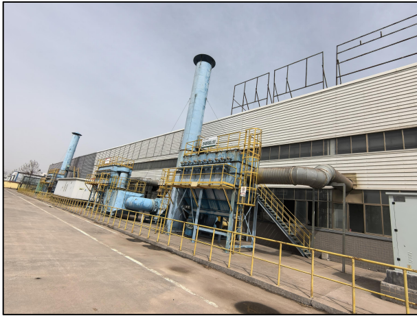
项目废气治理措施和排气筒 (DA001/002/003)
