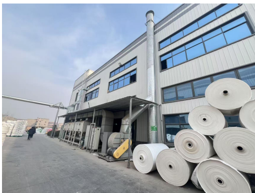
现有工程活性炭脱吸附+催化燃烧装置
